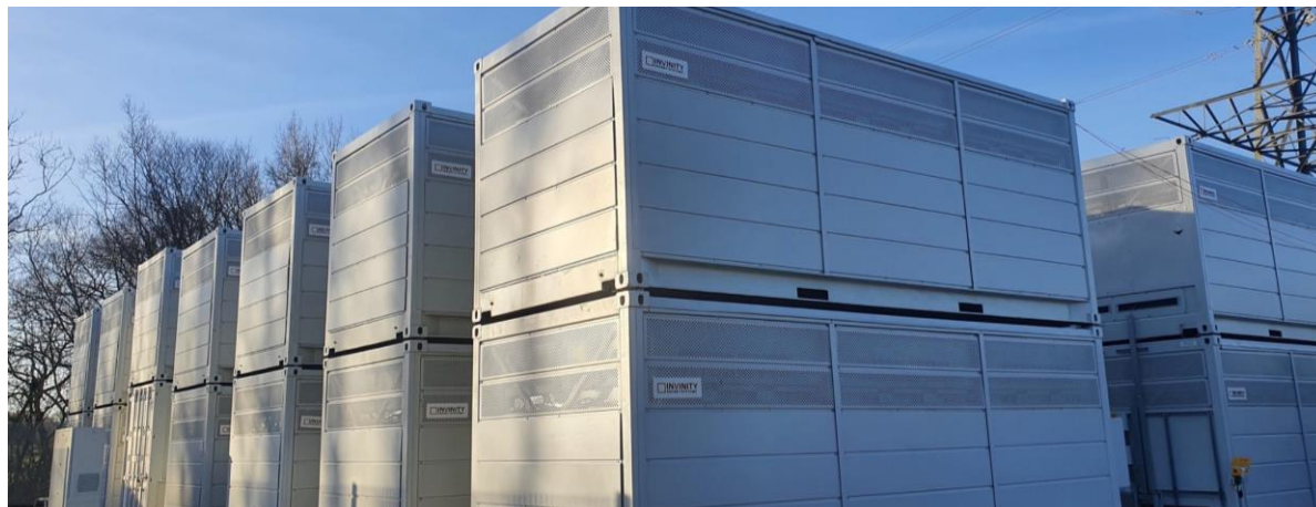
ENERGY SUPERHUB OXFORD / England FFR 5 MWh
